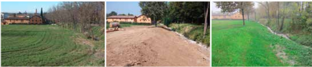
Figura 3 – Un altro esempio di allargamento di un rio (Rio Bianello) in sponda sinistra. In questo caso l'intervento è stato realizzato subito a monte di un tratto urbano, dove il rio diviene tombinato, e in una porzione limitrofa ad un terreno ad uso agricolo.
